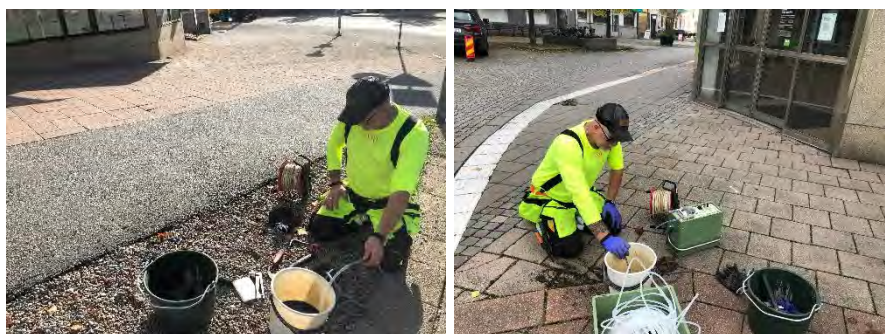
Figur 10. Rensumpning av grundvattenrör installerade 2016. GV2d med watterapump till vänster och GV1d med peristaltisk pump till höger.
