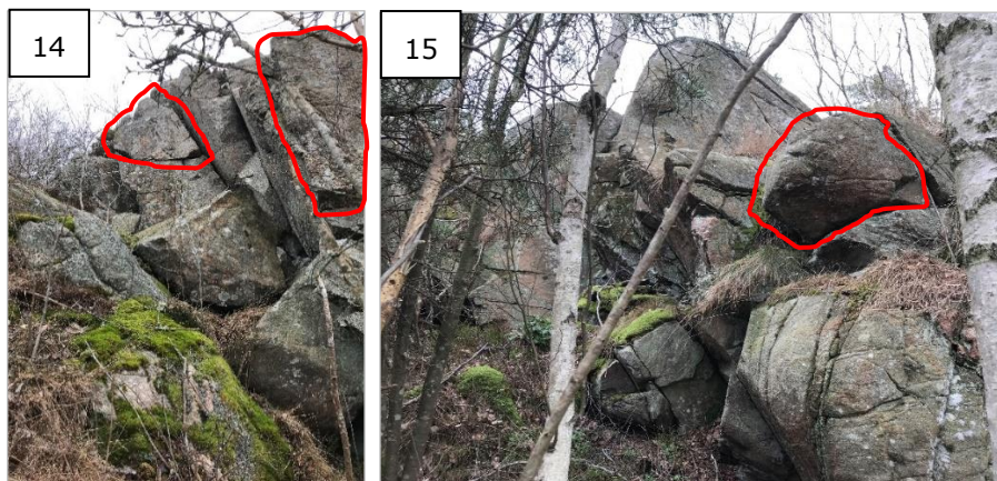
Figur 10. Vid observationspunkt 14 och 15 finns stora block i slänten som riskerar att falla ut.
