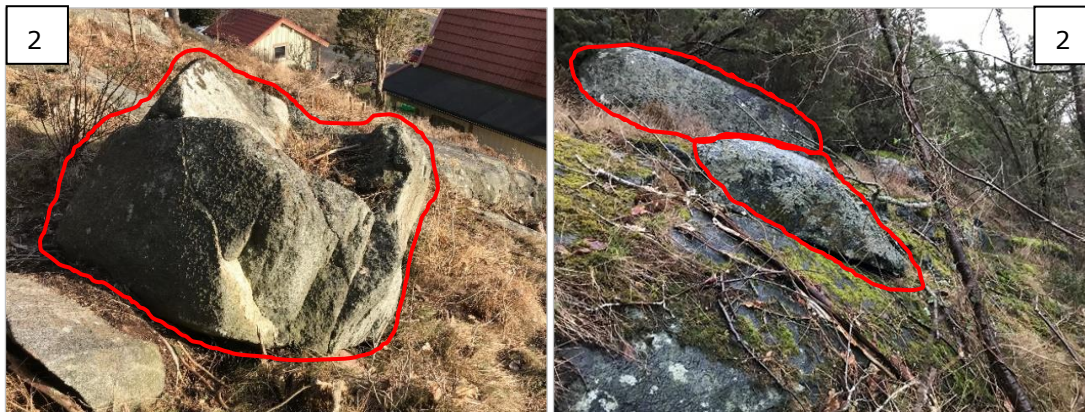
Figur 5. Det ligger lösa block i slänten som riskerar att glida ut vid vibrationsgenererande arbeten.
