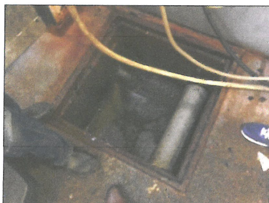
Figur 4. Slam-/oljeavskiljaren i spolhallen. Bolaget har installerat ett eget partikelfilter på inloppet till avskiljaren. Betvätskan neutraliseras innan filtret.
