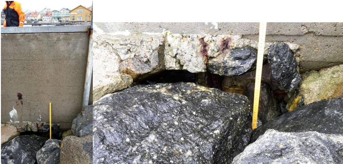
Bild 5. Betongpir, hålrum under konstruktioner.
