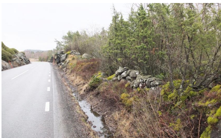
Stengärdesgårdar längs den västra delen av vägsträckan, är troligen samtida med vägen som invigdes 1940.
