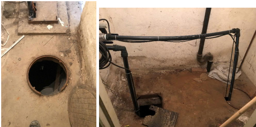
Figur 12. Pumpgropar placerade i respektive hus källare. Pumpgrop på Köpmannen 2 till höger och pumpgrop på Köpmannen 5 till vänster.
