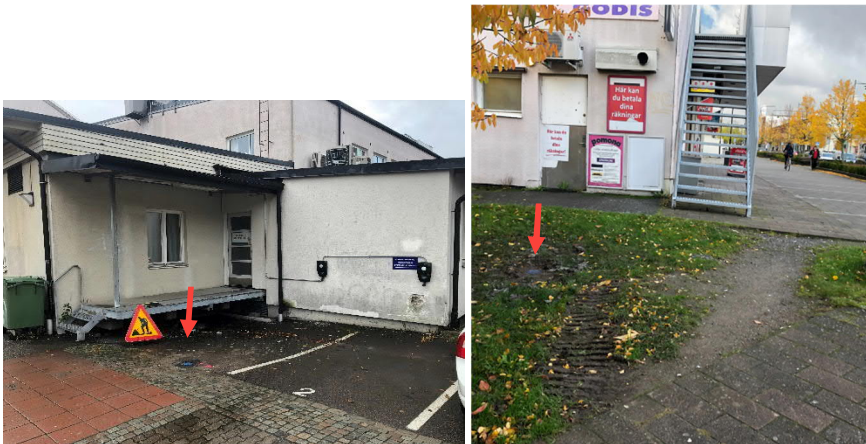
Figur 11. Grundvattenrör placerade i dexlar, GV3 till vänster och GV2 till höger.
