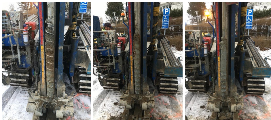
Figur 11. Skruvborrning av provtagningspunkt GV1d-Lila. Ytlig geologi bestående av grusigt sandigt fyller 0-0,6m med underliggande torrsorpelera 0,6-1,0m. Därunder följer lera 1,0-3,0 m (bild mitt och höger)
