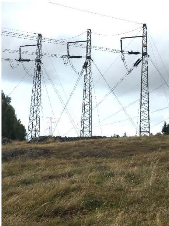
Figur 5. Exempel på standard vinkelstolpe. Används när luftledning byter riktning.
