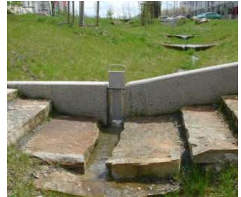
EXEMPEL PÅ DAGVATTENDIKE MED FÖRDRÖJNING. FOTO: NORCONSULT.
