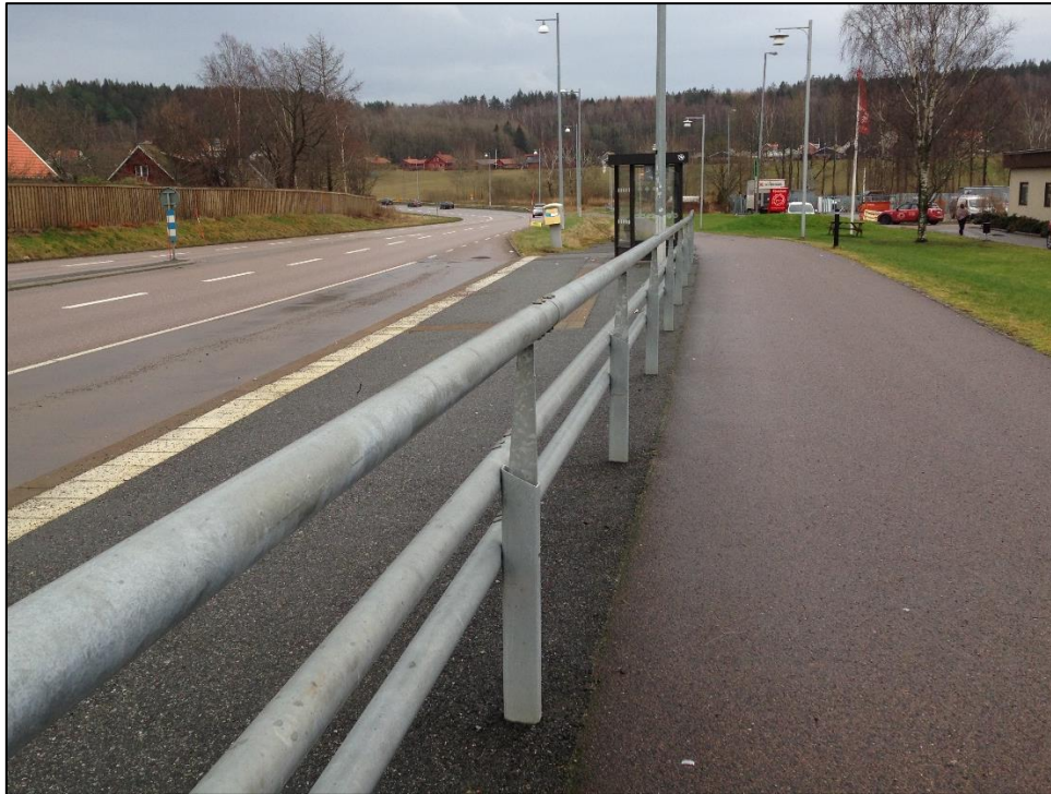
Figur 5. Avåkningsskydd vid planområdets nordvästra del, sett från väster (bild från platsbesök).
