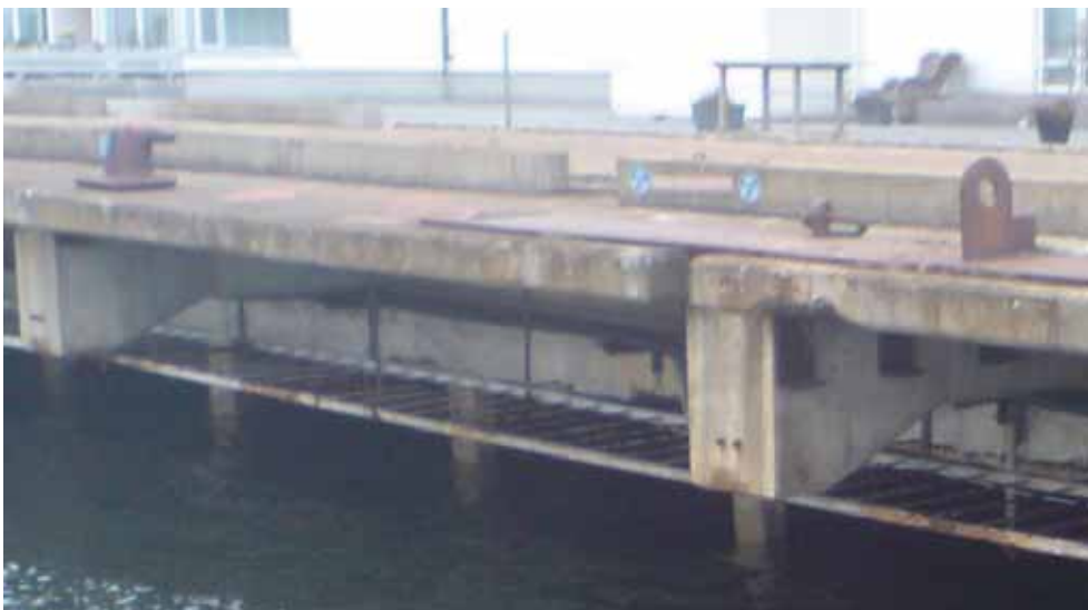
Bild 7. Betongkajen i södra delen av området. Vy åt nordväst. (Observera den blottlagda armeringen på den längsgående betongbalken ovan betongpålarna.)
