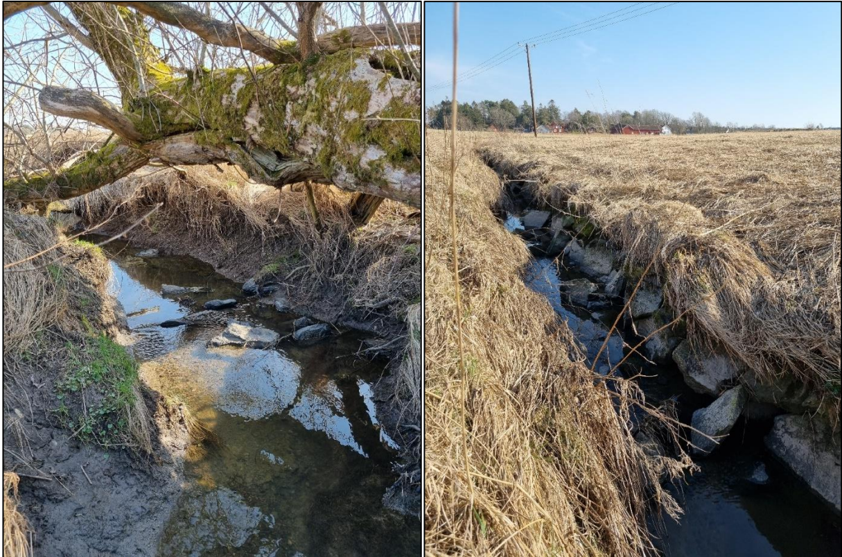
Figur 10-19 – Dokumenterad erosion och antaget erosionsskydd längs bäcken, Delområde 3 & 4.
