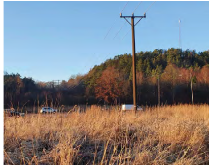
Kraftledningen, fotat där den korsar E6. Foto: Kungälv kommun
