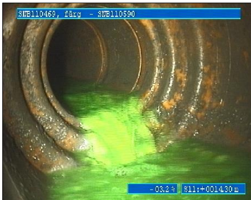
Figur 10. Färgat vatten från felkopplat stuprör vid TV-inspektion i spillvattenledning.
